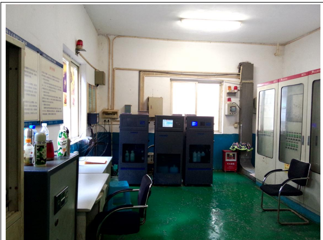
废水总排放口在线监控室
